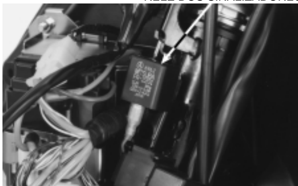
RELÉ DOS SINALIZADORES
